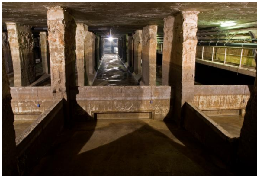
Figura 6.24.- Tanque de tormentas de Taulat. Fuente: BCASA- Ayuntamiento de Barcelona
