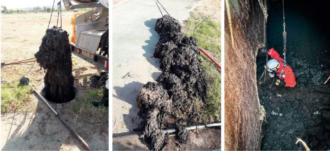
Figura 6.8: Retirada de toallitas higiénicas que provocan atascos en el sistema de saneamiento (acción correctiva). Fuente: EMASESA
