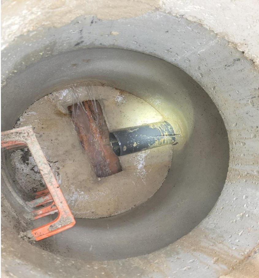
Figura 6.11 Infiltración en un pozo de registro (aguas parásitas). Fuente: HidroStank
